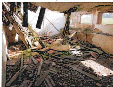
st. 191 - interier-spadlý strop
