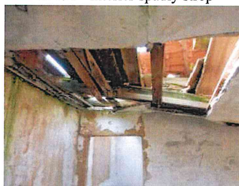
st.191- interier spadlý strop
