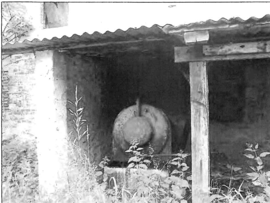
Obrázek 9: Nádrž na topnou naftu ohříváče vzduchu
