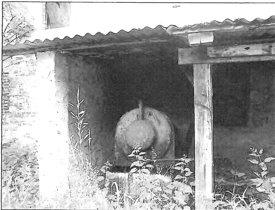
Obrázek 9: Nádrž na topnou naftu ohřivače vzduchu
