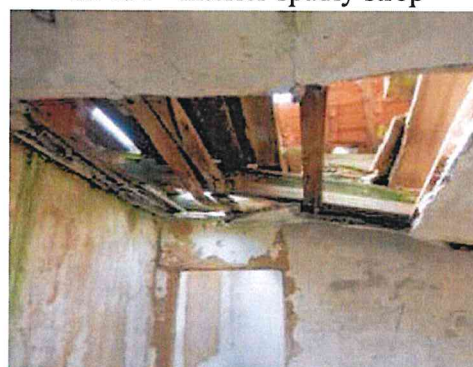
st.191- interier spadlý strop
