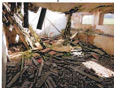
st. 191 - interier-spadlý strop
