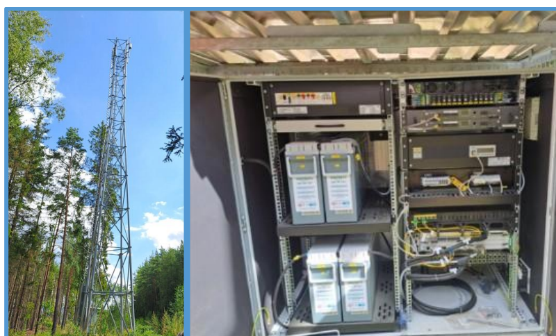
Obrázek 21: BTS (základnová stanice) Šneky a Datové centrum provozu - Nový Žďár (foto: Auditní orgán)
