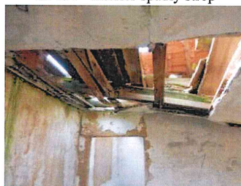
st.191- interier spadlý strop
